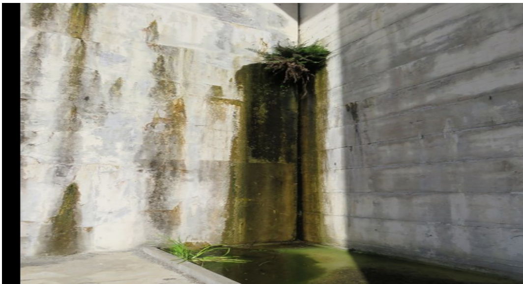
Ilustração 13 – Infiltração na junção da parede direita da eclusa com a parede de jusante da barragem.
