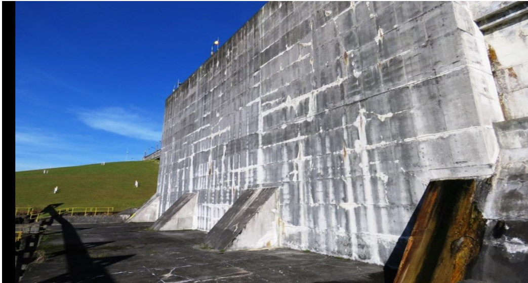
Ilustração 12 – Processos de lixiviação na parede de jusante e infiltração na base de um dos contrafortes.
